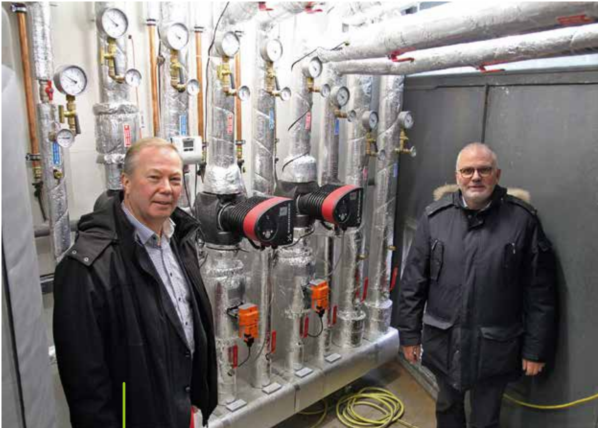
Die Heizung in St. Josef in Papenburg versorgt zehn Gebäude mit Wärme und teilweise auch mit Strom. Diese Anlage spart gegenüber einer dezentralen Heizung etwa 90 Prozent des CO 2 ein. Pfarrer Franz-Bernd Lanvermeyer (rechts) und der Geschäftsführer des St. Lukas-Heimes, Heinz-Bernhard Mäsker
